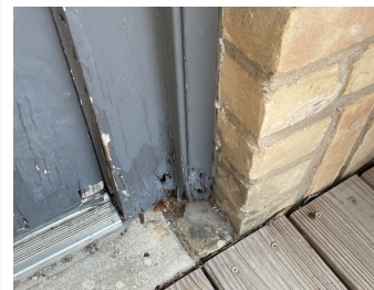
Replace rotted door jamb pieces (2 pieces)
