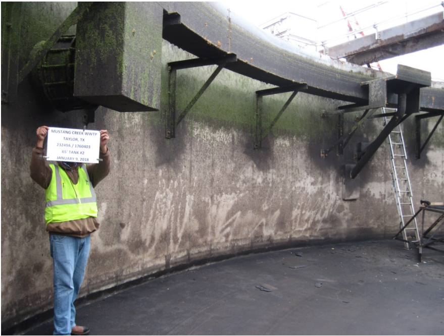
EFFLUENT DROP BOX
